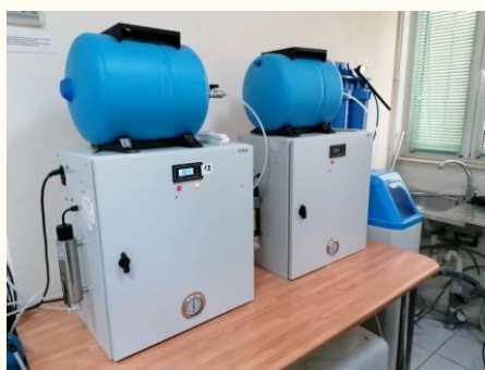
Σύστημα επεξεργασίας νερού
